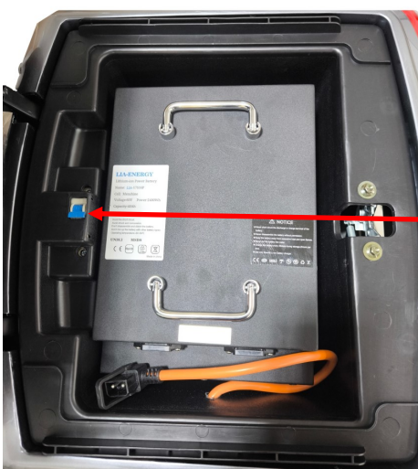
Hauptsicherung ein/aus (hier Bild von einem Lithiummodell)
