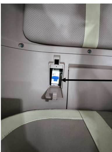
Hauptsicherung Ein/Aus (GFBA7-125, 80A)
