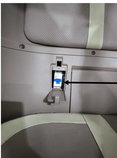
Hauptsicherung Ein/Aus (GFBA7-125, 80A)
