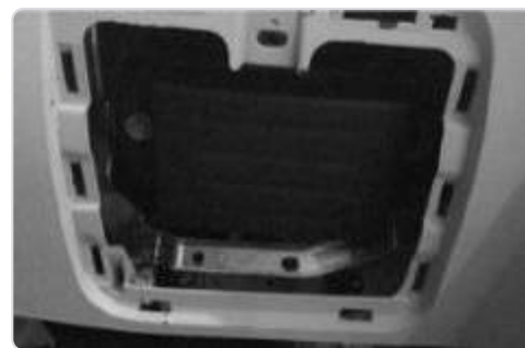
Sicherungskasten im Innenraum (Deckel abgenommen)
